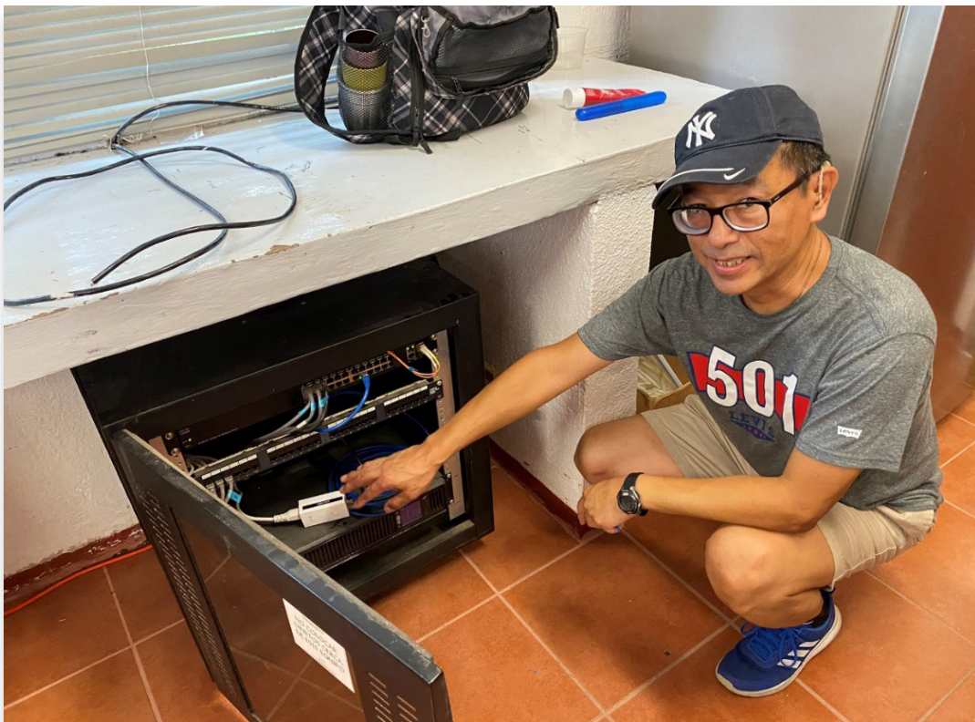
Instalación del nuevo sistema de antenas inalámbricas en laboratorios y habitaciones
